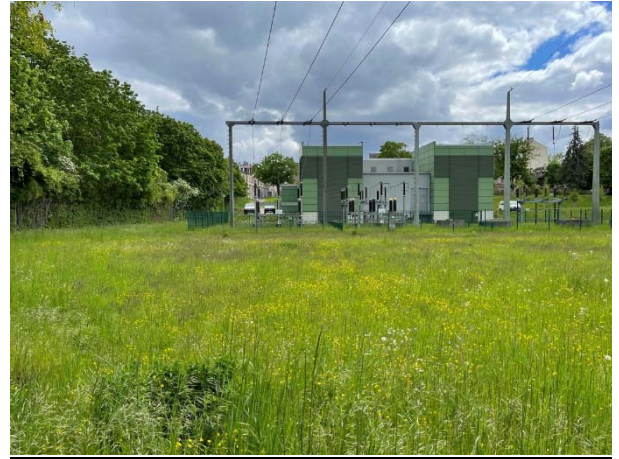
Abb. 15: Umspannwerk Dambacher Straße, Blickrichtung Osten
